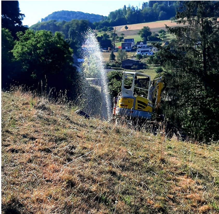
Foto vom Leitungsrohrbruch im Gebiet Kastelweid vom 03.08.2022, von Roger Hänggi
